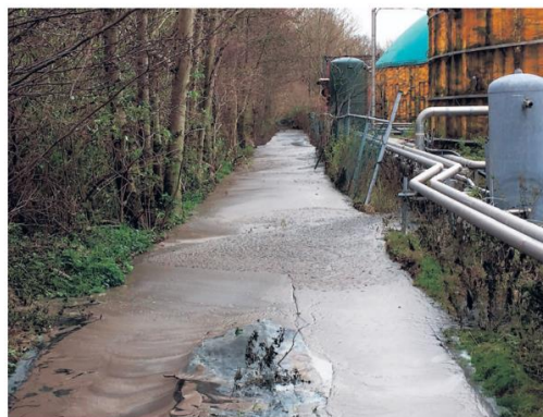
• Al een week stroomt mest uit een vergister. Volgens controleurs de schuld van het bedrijf, volgens het bedrijf het gevolg van foute ingrepen.
